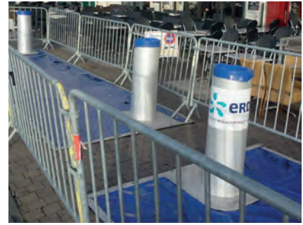
Figure 11. Quai Duperré, le long du Vieux Port, pas de protection particulière. Ce sera à chacun de protéger son entrée. On voit ici les bâches et les cheminées d'aération qu'ERDF dispose en cas d'alerte pour protéger les transformateurs électriques cachés sous le trottoir.
