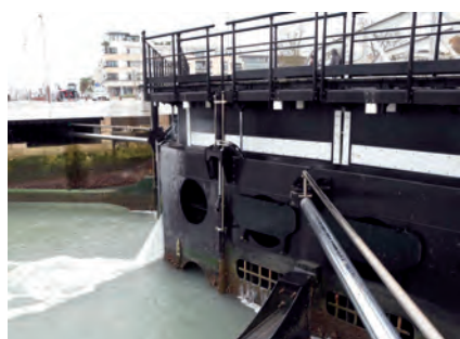
Figure 6. L'écluse du bassin des chalutiers est équipée d'un système de rehausse pour assurer la continuité de la protection contre la mer.
