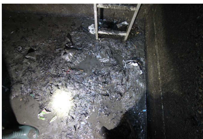
Figure 2 : Polluants piégés dans la chambre de tranquillisation du bassin les Sablons
