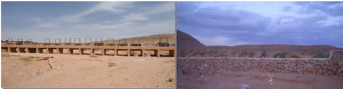
Photo1 : Tissambads de régulations du canal de Bouchène Photo 2 : Déversoir latéral du canal Bouchemdjene vers le canal de Bouchène
