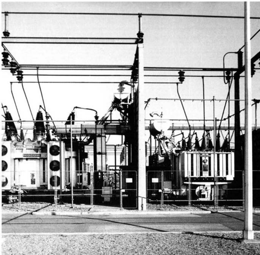
Un poste électrique à la Centrale
