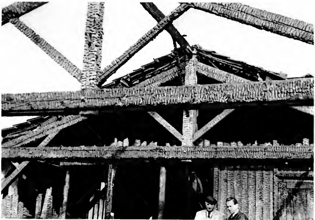
Résistance au feu des grosses pièces de charpente de bois. Malgré la carbonisation profonde, tout reste en place Photo SAPEURS-POMPIERS - PARIS
